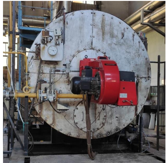
Слика бр.3: Котел бр.4
