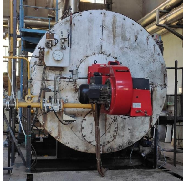
Слика бр.10: Котел бр.4
