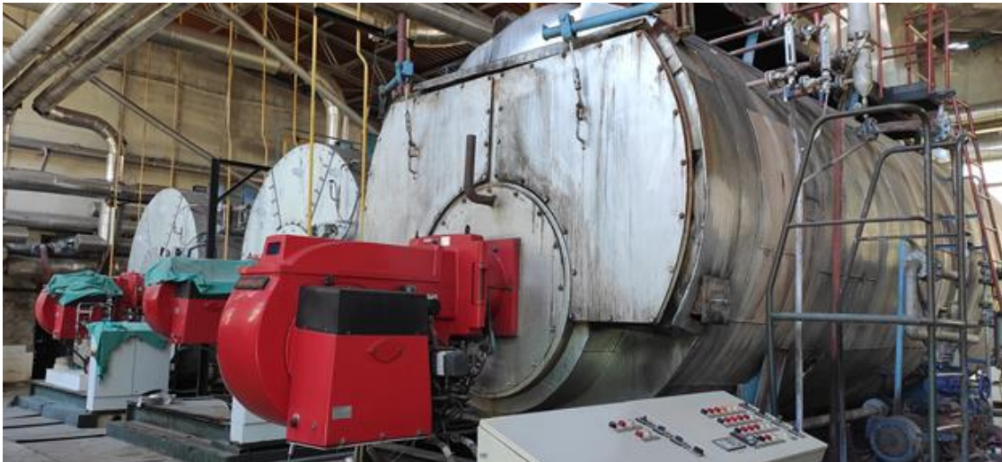
Слика бр.8: Котел бр.1, Котел бр.2 и Котел бр.3
