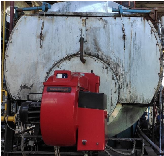
Слика бр.2: Котел бр.3
