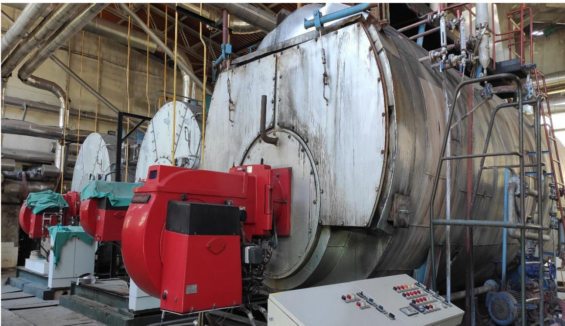
Слика бр.1 – Приказ на Парните котли при Главна Котлара
