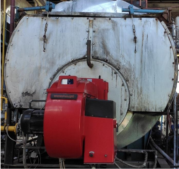
Слика бр.9: Котел бр.3
