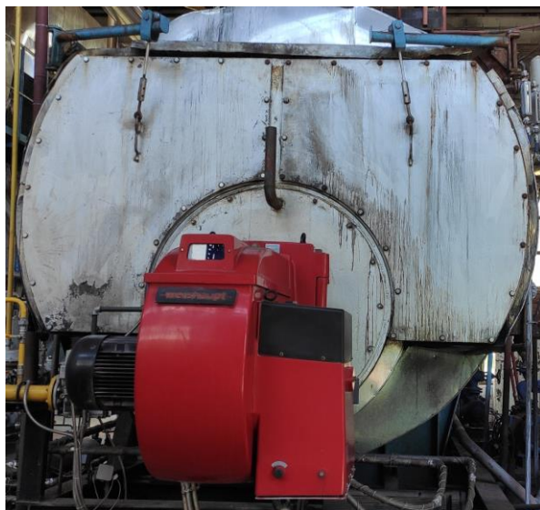
Слика бр.9: Котел бр.3
