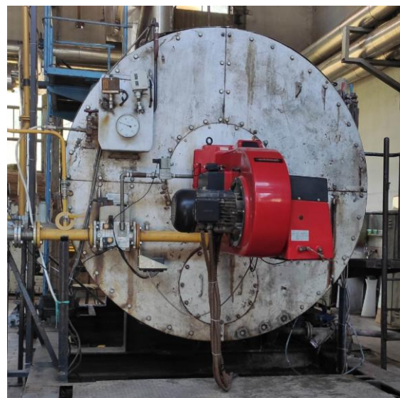
Слика бр.10: Котел бр.4
