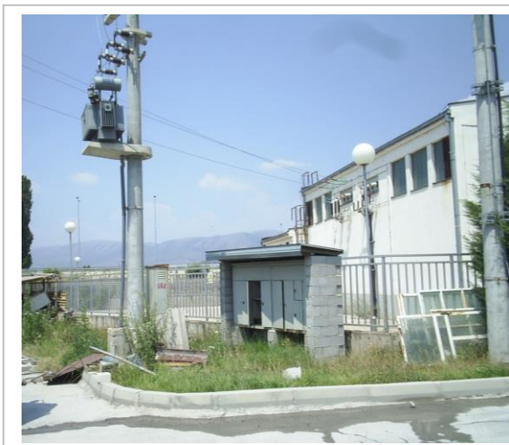
Слика бр. II.2-2: Трансформаторска станица на ЕВН и трансформатор на Гетоар (N 42.00585 E 21,32138)
