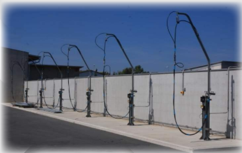
Станица за полнење со CNG/КПГ и возила за отпад кои користат CNG/КПГ (извор: Градот Виена)
